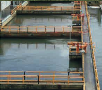
Diseño y asesoría para la construcción de la Planta de Tratamiento de Agua Potable Francisco Wiesner Colombia
